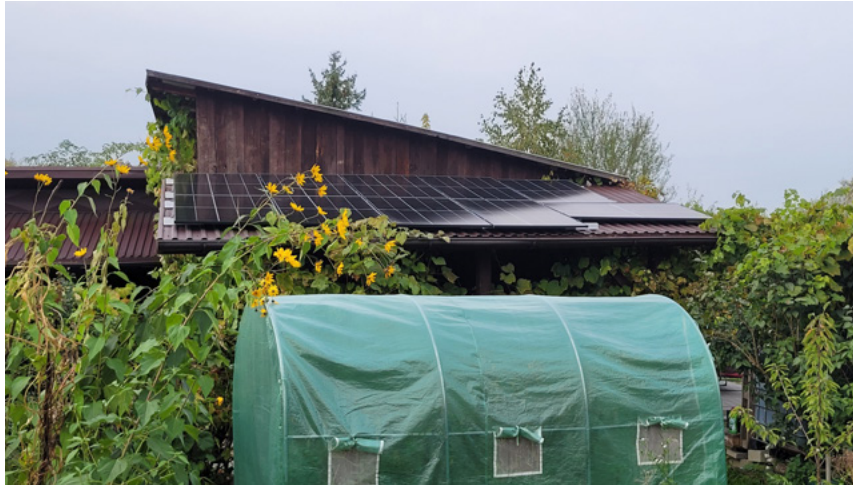
Panele fotowoltaiczne na budynku mieszkalnym
